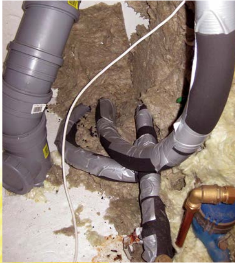
Putkia ja vesimittari teknisessä tilassa (Kuva 4)
