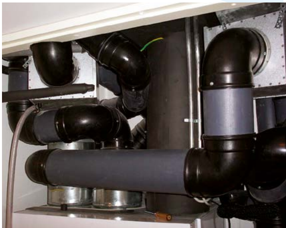
Iv-kanavista puuttuvat eristeet
