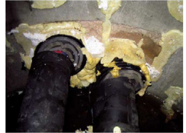
kuva 6. Tässä kaivossa läpivientejä täydennetty polystyreenipalasilalla
