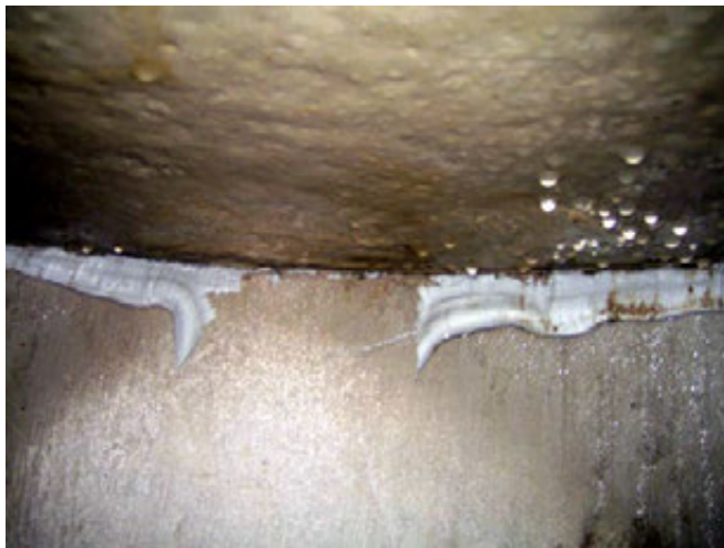
kuva 2. Kosteuden tiivistyminen betonikanteen; renkaan ja kannen tiivistys vajaa
