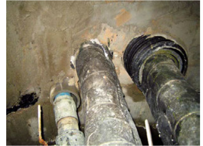
kuva 3. Kv-putken läpiviointi tiivistämättä; eristyslementtien tiivistys tehty pu-vaahdolla
