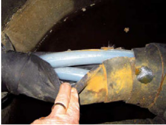
kuva 4. Lj-putkien eristys ohut ja revennyt
